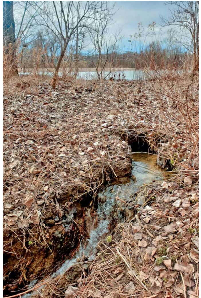
Narušená hráz rybníka Choryně.
